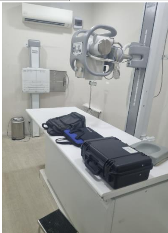
Foto do equipamento de raios X fixo.
